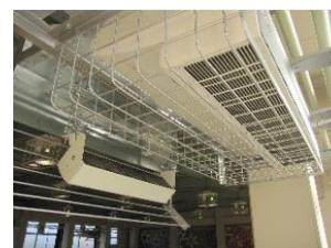
災害時にも利用可能な体育館の空調設備
